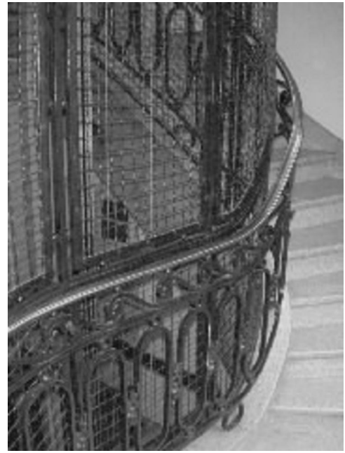
Une cage d'ascenseur historique, avec ferronnerie d'art : Prowinko veut démolir ce témoin d'architecture
