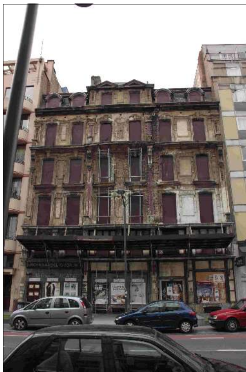
Le n° 98-106, complètement sinistré par la spéculation de son propriétaire, l'hôtel voisin Queen Anne
