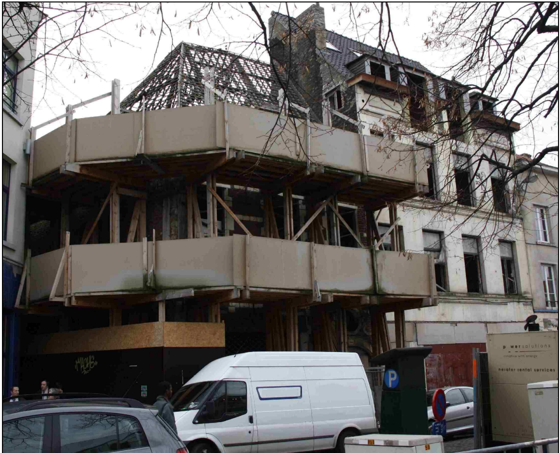
Dix ans séparent ces deux photos (1999 en haut, 2009 en bas). On mesure l'importance du processus de dégradation...et les tentatives désespérées de la Région de maintenir un bien classé dont le propriétaire veut la mort.
